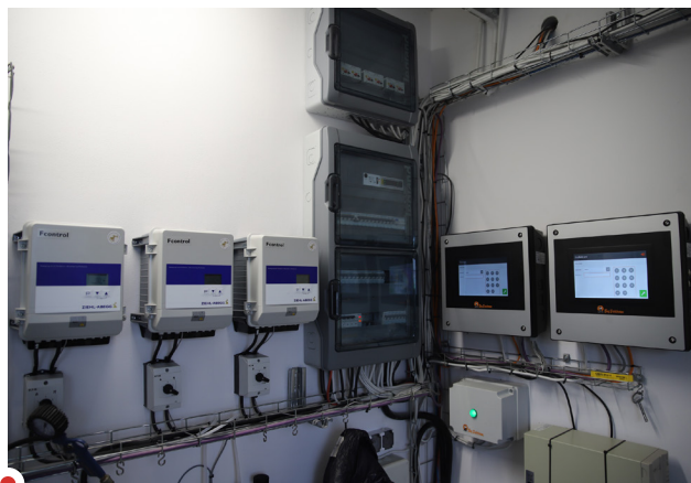
W sterowni znajdują się komputery do żywienia, sterowania wagą sortującą, wentylacją, system uzdatniania wody, dozowania preparatów oraz rozdzielacze do sterowania zaworami pneumatycznymi do automatów paszowych.
