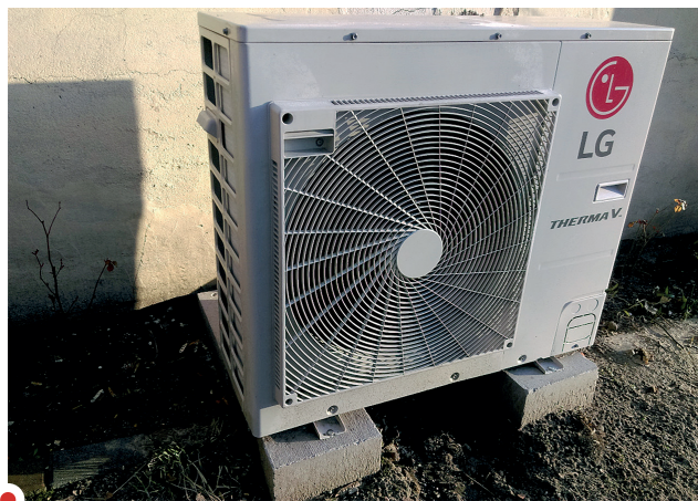
Pompy ciepła dają znaczne oszczędności w ogrzewaniu. Szczegółne efektywne są pompy gruntowe, choć i te powietrzne niewiele im ustępują, wyróżniając się na plus na tle innych rozwiązań (Fot. L. Tupalski)
