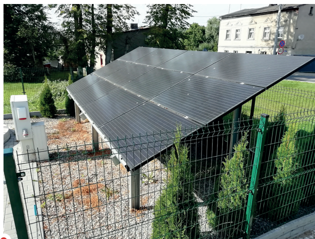
Instalacja fotowoltaiczna o mocy 3,3 kW zasilająca przepompownię w Gębicach w kujawsko-pomorskim wykonana na zamówienie gminy Mogilno w ramach rozbudowy kanalizacji sanitarnej. Inwestycja ta jest przykładem projektu, który może być realizowany przez samorządy (Fot. L. Tupalski)
