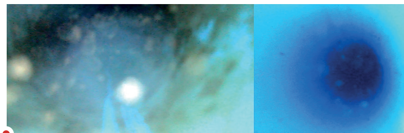
Fot. 1, 2. Zdjęcie linii wewnątrz, widoczne osady na ściankach oraz materia organiczna w wodzie
